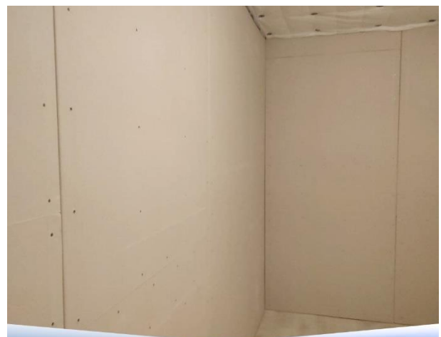
ШУМОИЗОЛЯЦИЯ СТЕН И ПЕРЕГОРОДОК. БЕСКАРКАСНАЯ УСИЛЕННАЯ СХЕМА. СНИЖЕНИЕ ШУМА ДО 55-65%! Монтаж ГКЛ. Финишный слой.
